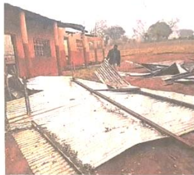
Die Reparatur der Schäden überfordert den Förderverein. FOTO:VEREIN
